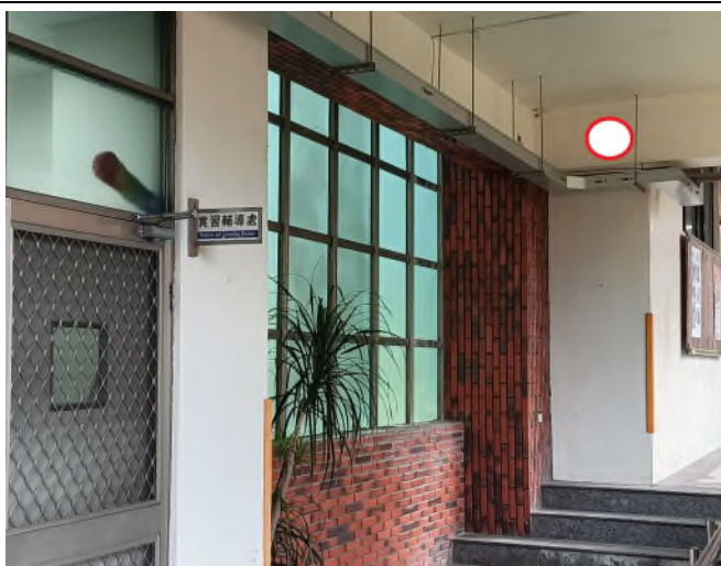
編號 7 實習大樓二樓實輔處前門樑角落
